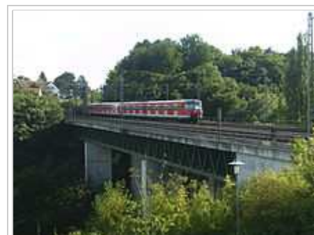
Das im April 1945 zerstörte Nesenbachviadukt in Stuttgart-Vaihingen wurde 1946 wiederaufgebaut. 1982/1983 erfolgte ein viergleisiger Neubau.
